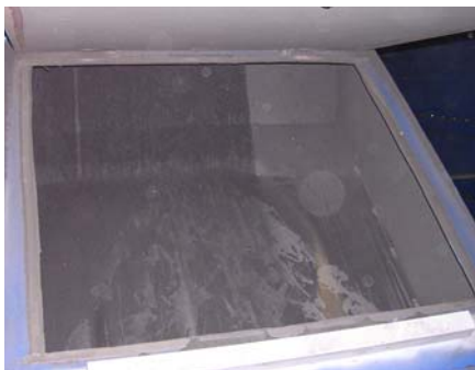
Sanddurchlauf im Kaskadensichter
